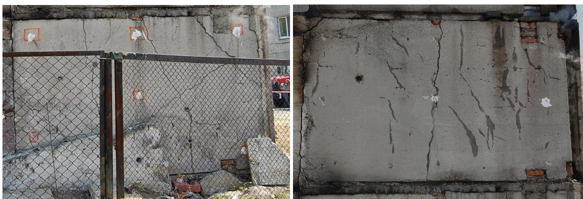
а) б) Рис. 5. Характер тріщиноутворення в стінових панелях: а – плита першого поверху; б – плита другого поверху
