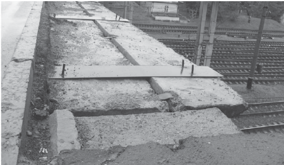
Рис. 1. Загальний вигляд ділянки шляхопроводу зі зміщеними балками після демонтажу тротуарних блоків і їх тимчасового закріплення металевими пластинами
