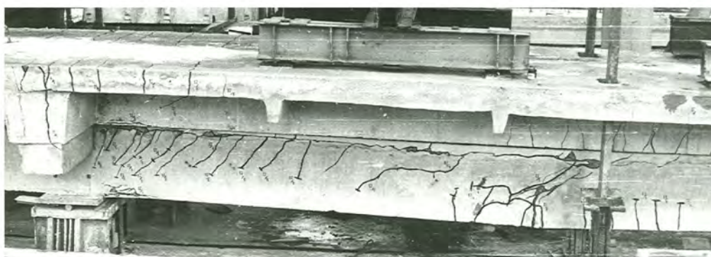
Рис. 3. Характер тріщино утворення в над опорній зоні стіку консольної балки
