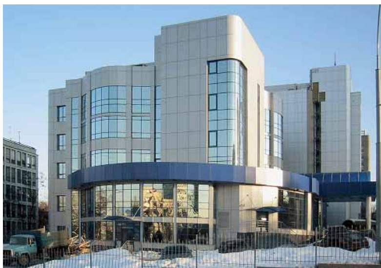
Реконструкція будівлі під лікувально-діагностичний центр на вул. Солом'янській, 11-А в м. Києві, 2003 р.
