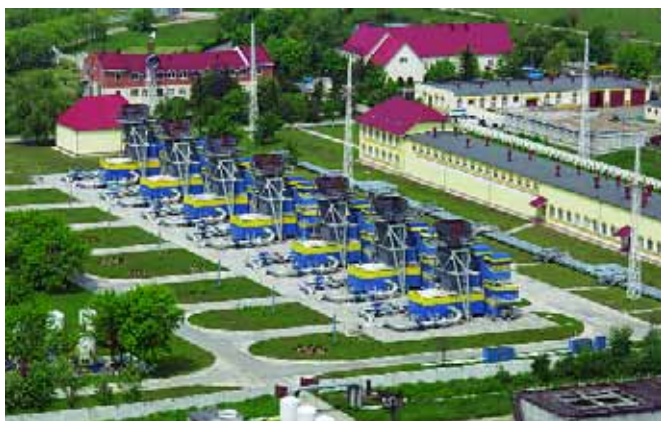
Компресорна станція «Ужгород»
