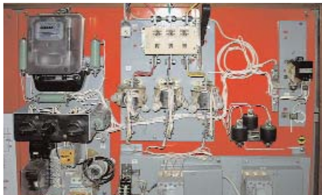
Розподільчий щит трансформаторної підстанції системи електроспоживання
