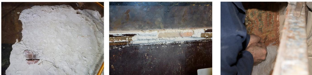
Рисунок 5.3.32.-5.3.4. Розчистка та виявлення ушкоджень та втрат тинькового шару, скульптурної пластики та художніх розписів.
