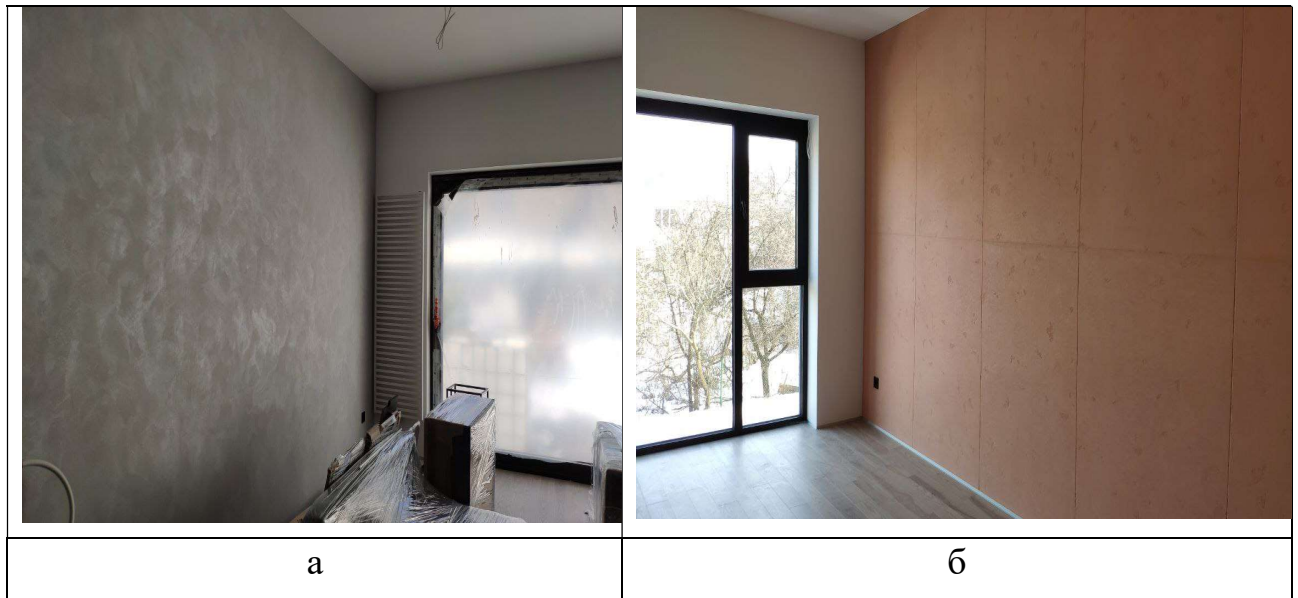
Рисунок 5.7 – Загальний вигляд внутрішніх стін по вул. Балтійській м. Львова, покритих фотокаталітичною нанорідиною
