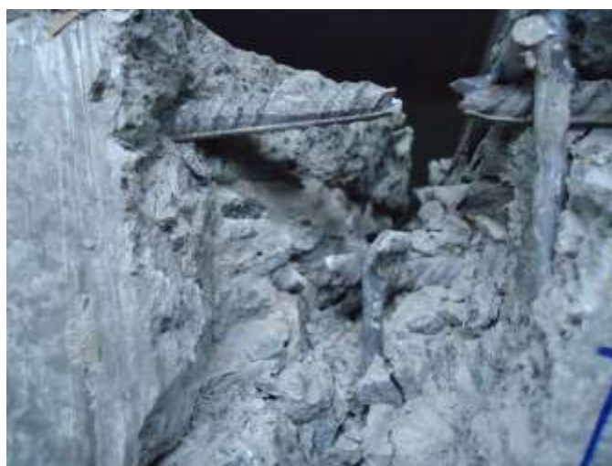
Рис.3.25. Розрив обох шарів розтягнутої поздовжньої арматури
