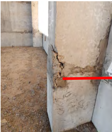
Рис. 12. Відшарування бетону замонолічування ніші стику
