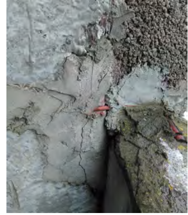
Рис. 11. U-подібні арматурні елементи з'єднання стінових панелей з колонами відгинають арматуру стику, утворюючи тріщини в бетоні замонолічування ніші
