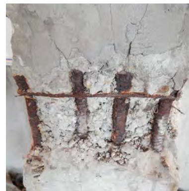
Рис. 8. Арматура в стикі має поверхневу корозію. Руїнування та деградація бетону замонолічування ніші
