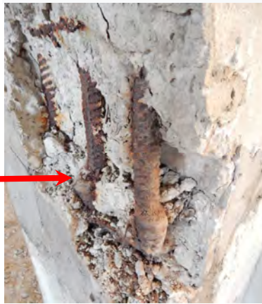
Рис. 13. Вертикальні тріщини та порожнини в бетоні замонолічування ніші стику
