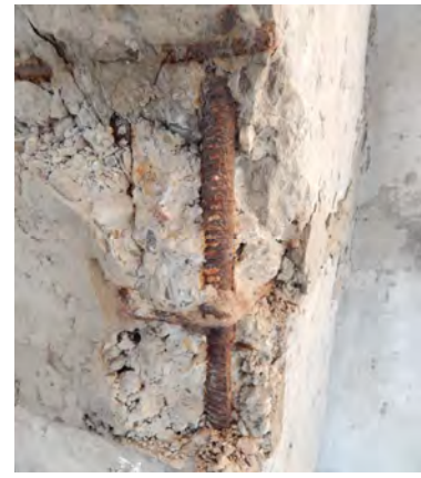
Рис. 14. Відшарування ділянки бетону, поверхнева корозія арматури, нецільний бетон замонолічування ніші стику
