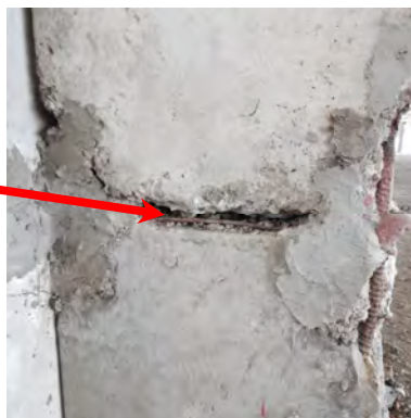
Рис. 7. Проміжок між торцями колон у стикі не зароблено жорстким розчином. Встановлено гнуті хомути з нерівних арматурних стрижнів
