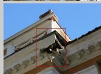
Частково зруйновано карниз та ліпний декор
