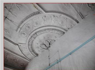
Влаштовано нову перегородку, що не лише вносить зміни в авторську схему розпланування палацу, але й руйнує вишукану ліпнину на стелі
