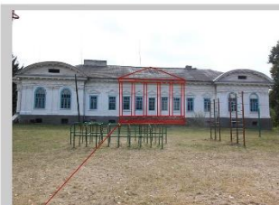
Зруйнований портик на головному фасаді
