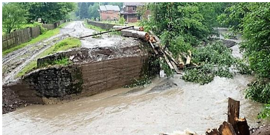
Рис. 1.3 Зруйнований міст біля села Устеріки Верховинського району (2018 р.) [69]
