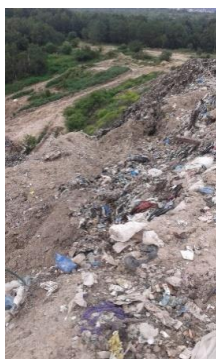
Рис. 4.7. Тріщина в південній частині полігону ТПВ 23.06.2016 р.
