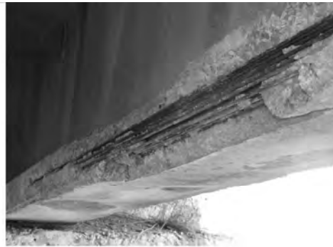
Рис. 4. Відшарування захисного шару бетону, корозія робочої арматури балки
