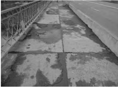
Рис. 1. Відсутність покриття та гідроізоляції на тротуарах
