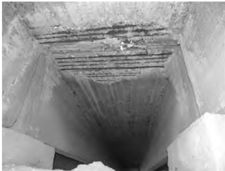
Рис. 3. Пошкодження захисного шару бетону, корозія арматури плити
