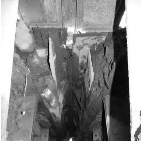
Рис. 1. Пошкодження елементів деформаційних швів
