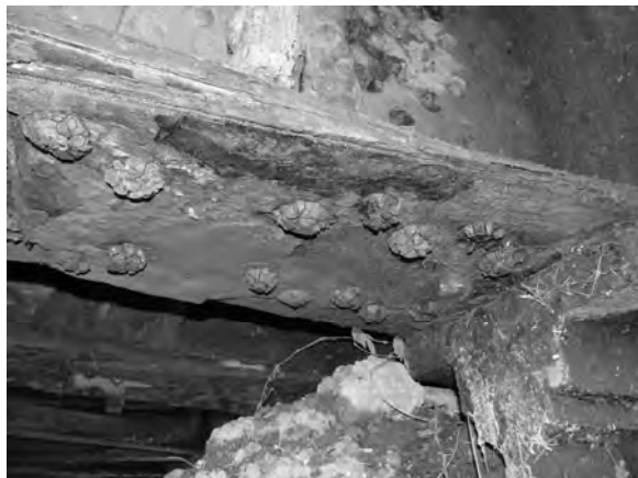
Рис. 4. Значна корозія металу з ослабленням усіх елементів
