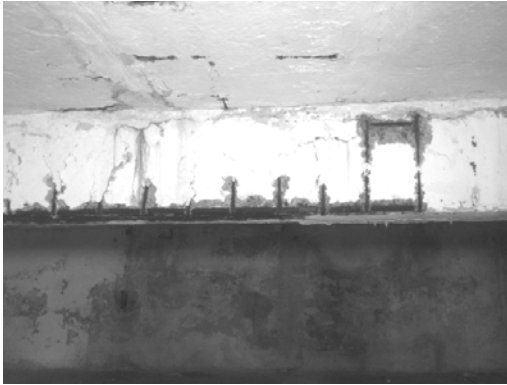
Рис. 1. Пошкодження центрального несучого ригеля
