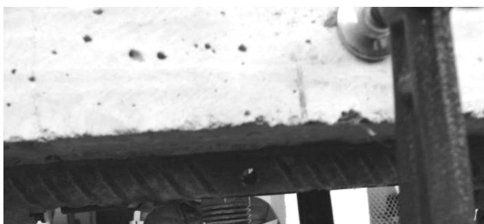
Рис. 3. Пошкодження у вигляді отвору в розтягнутій арматурі
