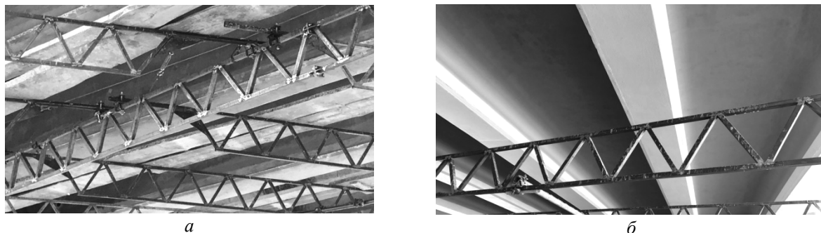
Рис. 2. Вид знизу до (а) і після (б) ремонту технологіями і матеріалами Sika
