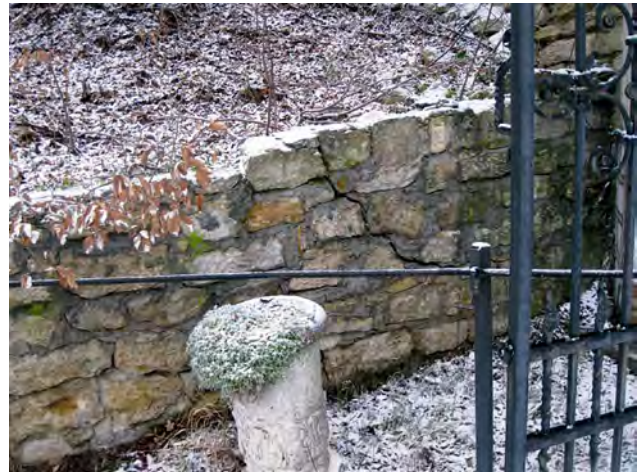
Рис. 8. Фотофіксація тріщини підпірної стінки схилу тераси
