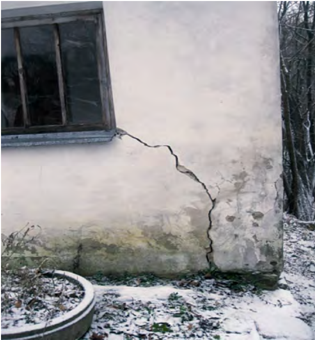
Рис. 3. Фотофіксація тріщини (деформації) споруди на території Підгорецького монастиря
