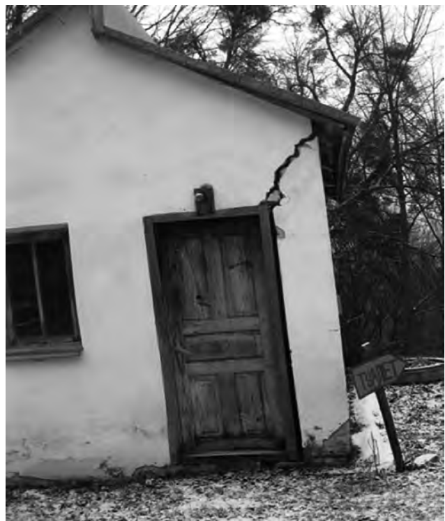
Рис. 2. Фотофіксація тріщини (деформації) споруди на території Підгорецького монастиря
