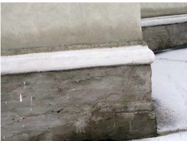
Рис. 5. Фотофіксація тріщини (деформації) фундаменту будівлі храму
