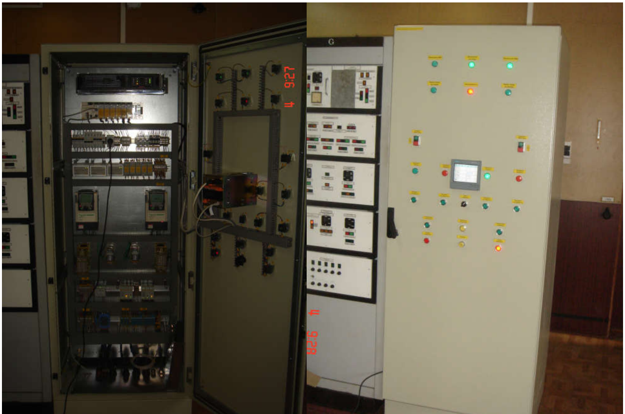
Рис.4.1. Вигляд зовнішньої та внутрішньої панелі щита системи автоматичного керування тиску на нафтоперекачувальній станції «Плецівка» філії «Магістральні нафтопроводи «Дружба» ПАТ «Укртранснафта»
