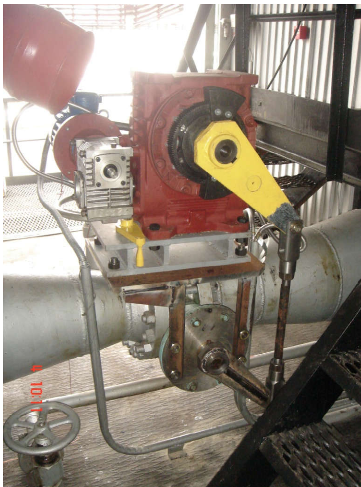
Рис.2.9. Регулюючий орган типу поворотна заслінка разом з електричним виконавчим механізмом встановлені на трубопроводі на одній з НПС.
