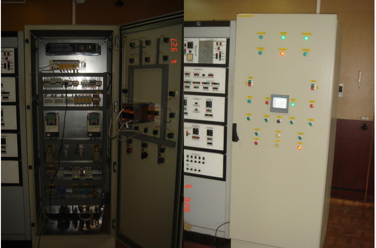
Рис.13. Вигляд зовнішньої та внутрішньої панелі щита системи автоматичного керування тиску на нафтоперекачувальній станції «Плещівка» філії «Магістральні нафтопроводи «Дружба» ПАТ «Укртранснафта»
