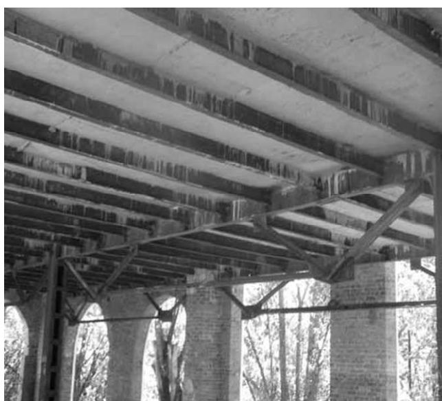
Рис. 7. Використання комбінованих металевих статично невизначених конструкцій як несучих елементів сталезалізобетонного перекриття будівлі басейну
