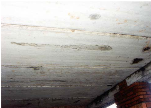
Рис. 5. Тріщина вздовж другої від краю порожнини (фото, вигляд знизу)
