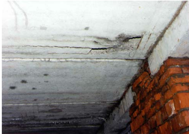
Рис. 4. Відколювання бетону нижньої грані плити біля опори (фото, вигляд знизу)
