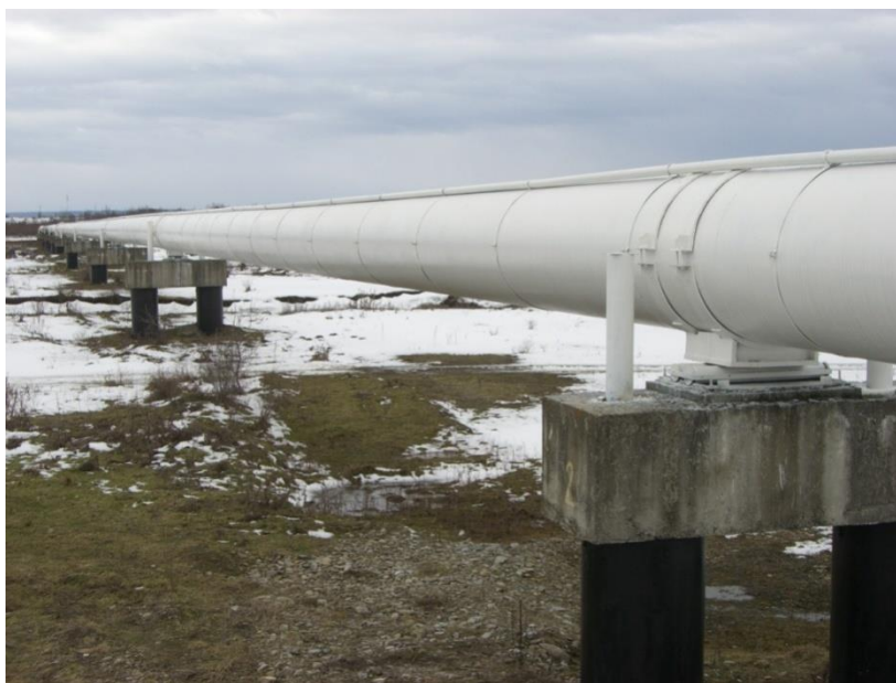
Рис. 2.3 Надземний перехід газопроводу “Уренгой – Помари – Ужгород” через р. Бистриця Солотвинська
