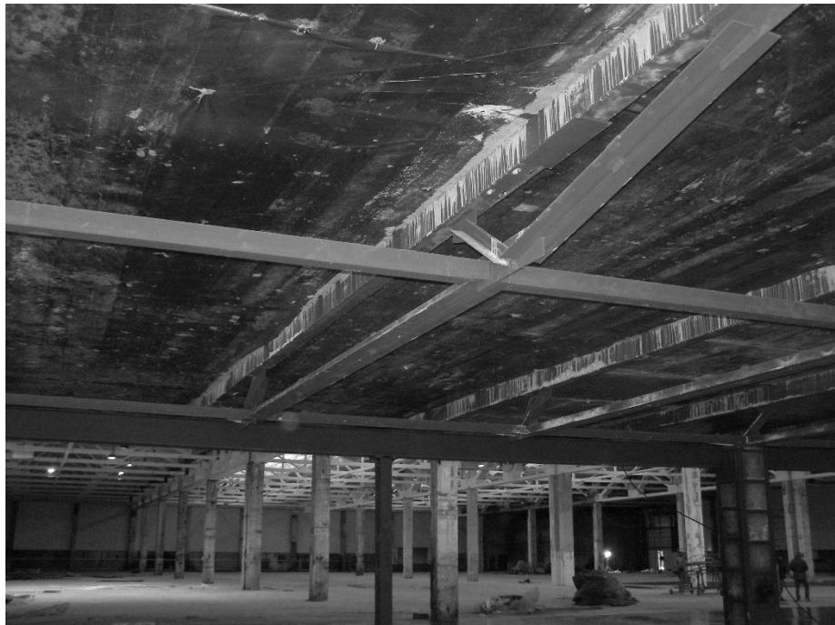
Рис.4.8. Металева комбінована конструкція перекриття в процесі влаштування на будівлі ТЗОВ «Лемберг» по вул. Б.Хмельницького в м. Львові
