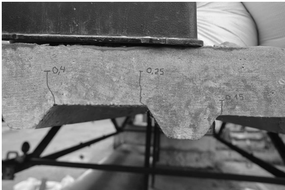
Рис.3.15. Тріщини в плиті (КСБ-3)
