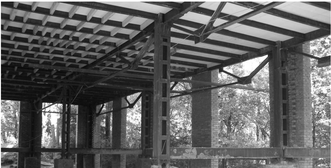
Рис.4.19. Сталезалізобетонне перекриття будівлі відпочинкового корпусу ТзОВ «Трускавецьінвест» на стадії бетонування (проліт 10м)
