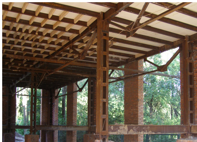
Рис. 14. Сталезалізобетонне шпренгельне перекриття на стадії бетонування будівлі відпочинкового корпусу ТзОВ «Трускавецьінвест» (проліт 10 м)
