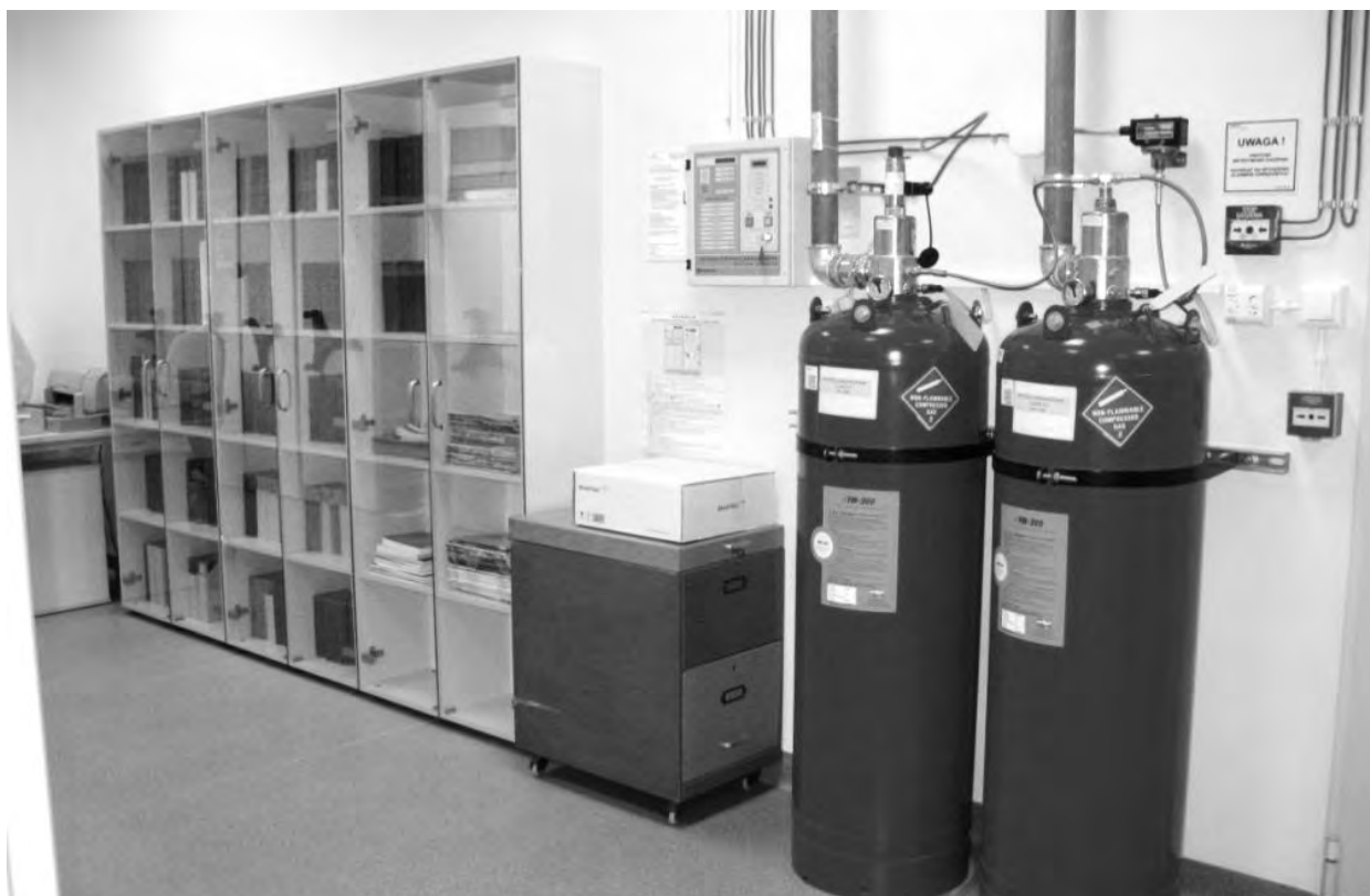
Fot. 17. Specjalistyczny sprzęt przeciwpożarowy.
