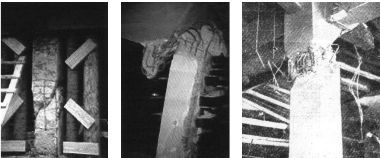
Рис. 1. Руйнування колон нижніх поверхів по нахиленому перерізу після землетрусу [1]: а, б – у Бухаресті 4 березня 1977 р.; в – у Ташкенті 26 квітня 1966 р.
