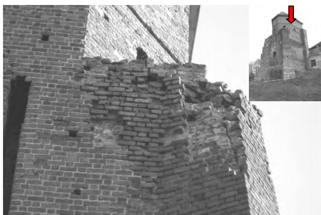
Fot. 7. Uszkodzenia szkarpy od strony południowo – zachodniej, fragment, który jest uszkodzony jest rekonstrukcją z cegły współczesnej – listopad 2011 r.(Fotografia własna)
