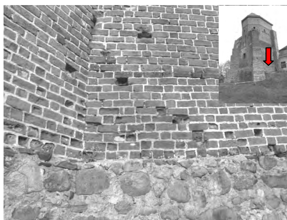
Fot. 8. Uszkodzenia muru spowodowane zbyt mocną zaprawą użytą naprawy i zawilgoceniem muru – listopad 2011r. (Fotografia własna)
