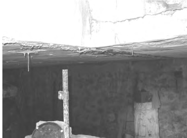
Fot. 10. Korozja spowodowana zawilgoceniem, widoczne „stalaktyty” soli wykrystalizowanych na powierzchni – listopad 2011 r. (Fotografia własna)
