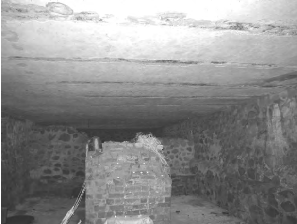
Fot. 9. Widok na pomieszczenia piwnic, widoczna korozja stropu oraz zawilgocenie i korozja ścian piwnic – listopad 2011 r. (Fotografia własna)
