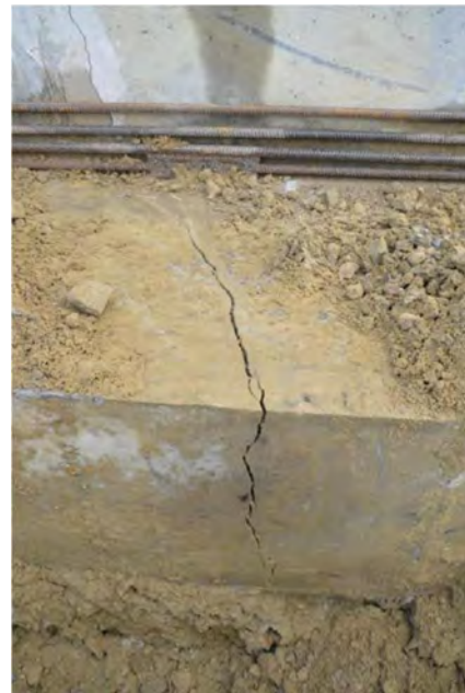
Рис. 4. Утворення тріщини на стіні і подушці фундаменту між осями 2...3 по осях А...Б
