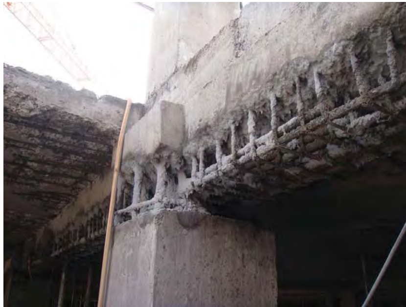
Рис.1. Дефекти в основних елементах каркасу внаслідок неякісного бетонування в зимовий період
