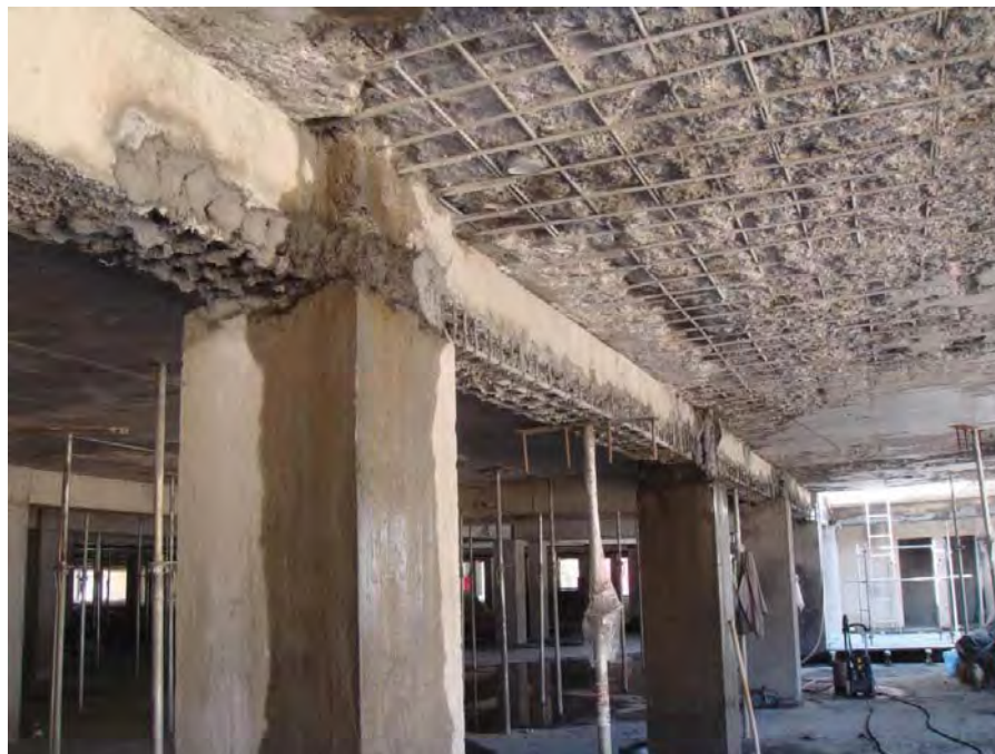
Рис. 2. Дефекти в монолітній плиті перекриття внаслідок неякісного бетонування в зимовий період
