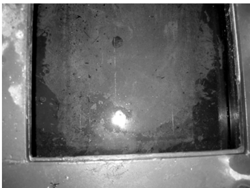
Рис. 3. Застій води у замкненому просторі між металевими балками рами компресора
