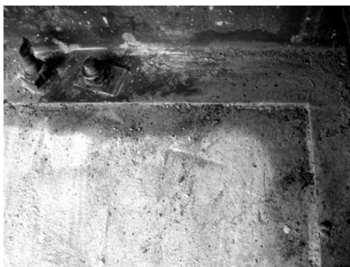
Рис. 4. Процес фільтрації води через бетон підготовки під поперечною балкою Б-6 рами компресора
