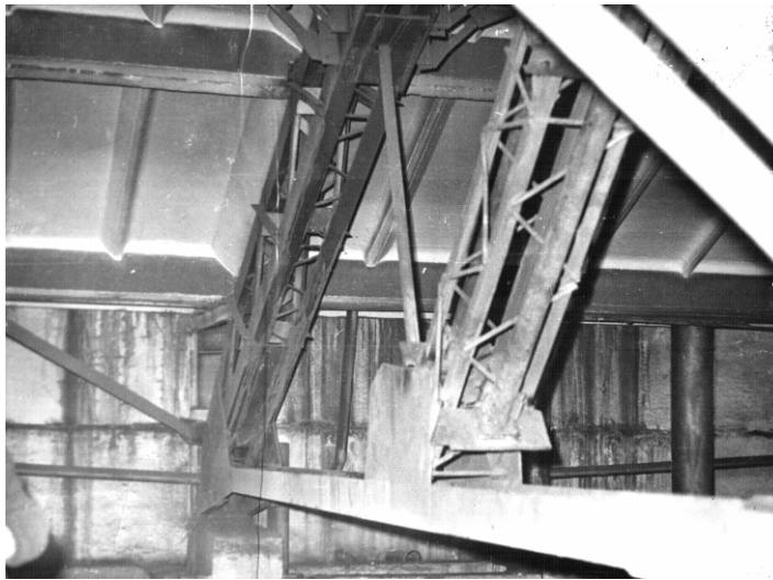
Рис. 11. Посилення стиснутих розкосів ферм покриття прольотом 36 м котельні Бурштинської ТЕС
