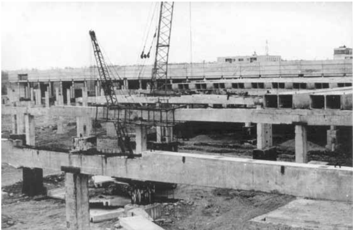
Рис. 57. Загальний вигляд монтажу багатопрогонних нерозрізних балок покрить з напружуваними стилями (сітка колон 12×18 м)
