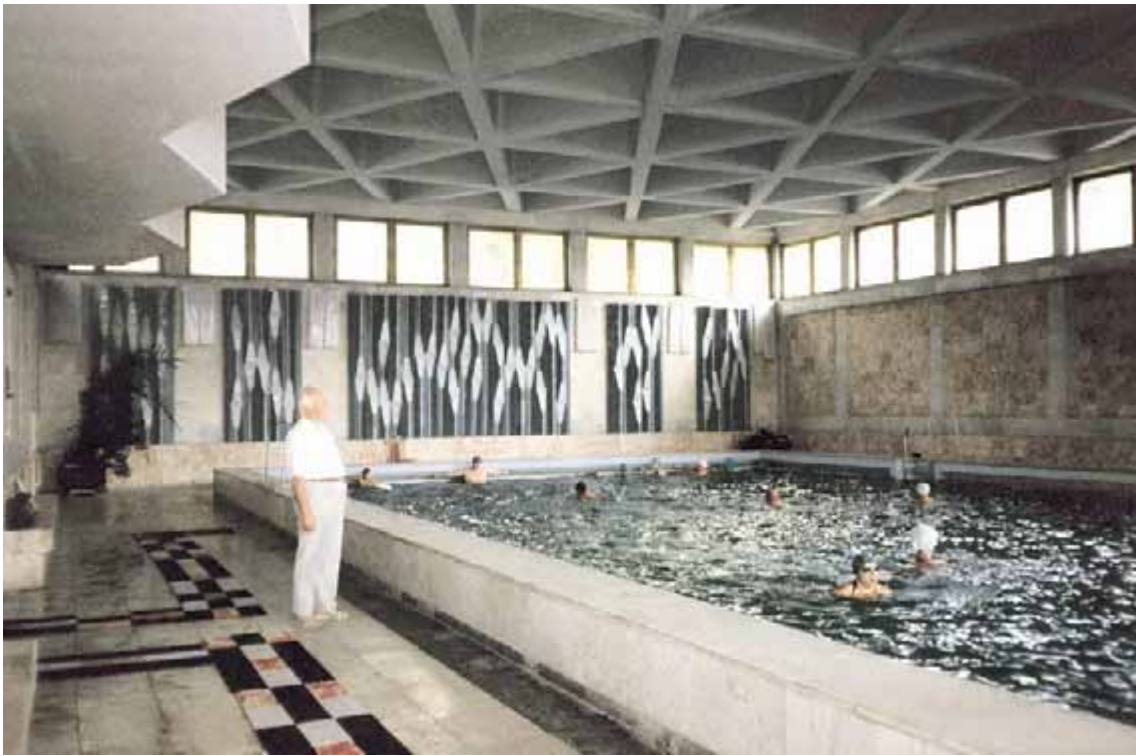
Рис. 18б. Збірно-монолітне перекриття плавального басейну розмірами 18 × 30 м (м. Трускавець, санаторій “Кришталевий палац”)
