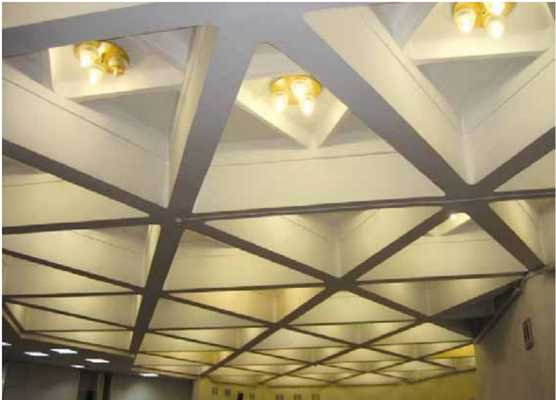
Рис. 20а. ЗМКП актового залу непрямокутної форми для великих навантажень (м. Львів, стилобат адміністративного будинку на вул. Стрийській)
