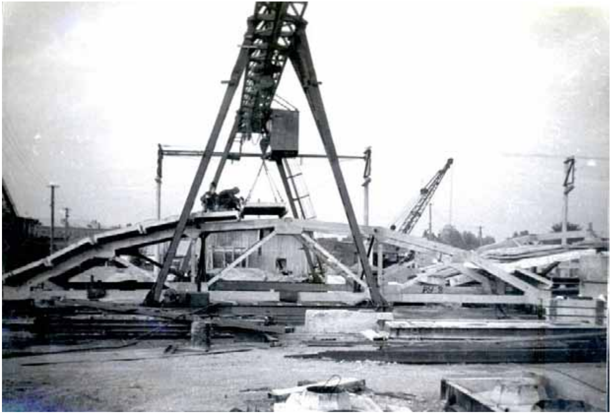
Рис. 4. Випробування полігональних залізобетонних ферм, складених з лінійних елементів на заводі ЗБК №1 в м. Львові
