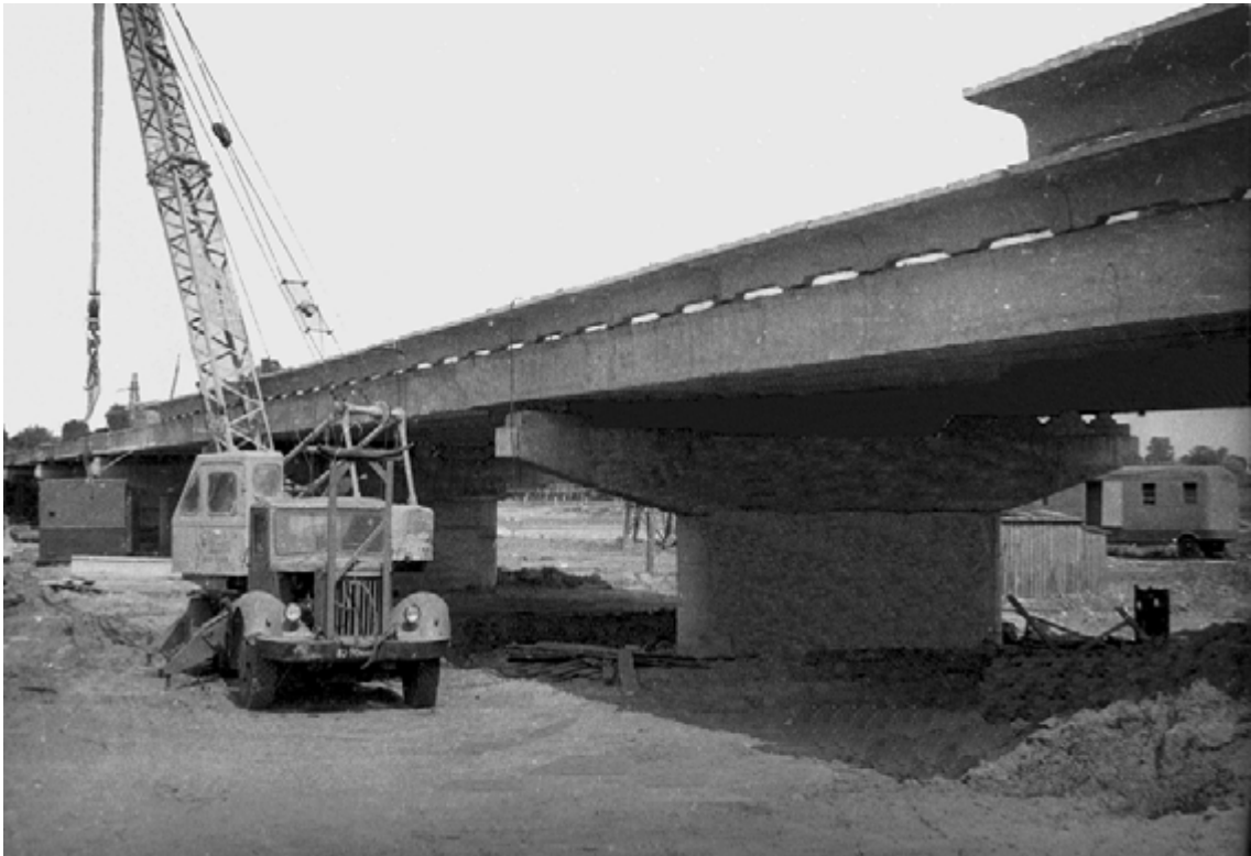
Рис. 26. Будівництво багатопроганового нерозрізного моста з напружуваними стиками з пустотних плит (Житомирська область, р. Уж, прогони – 24,0 м)
