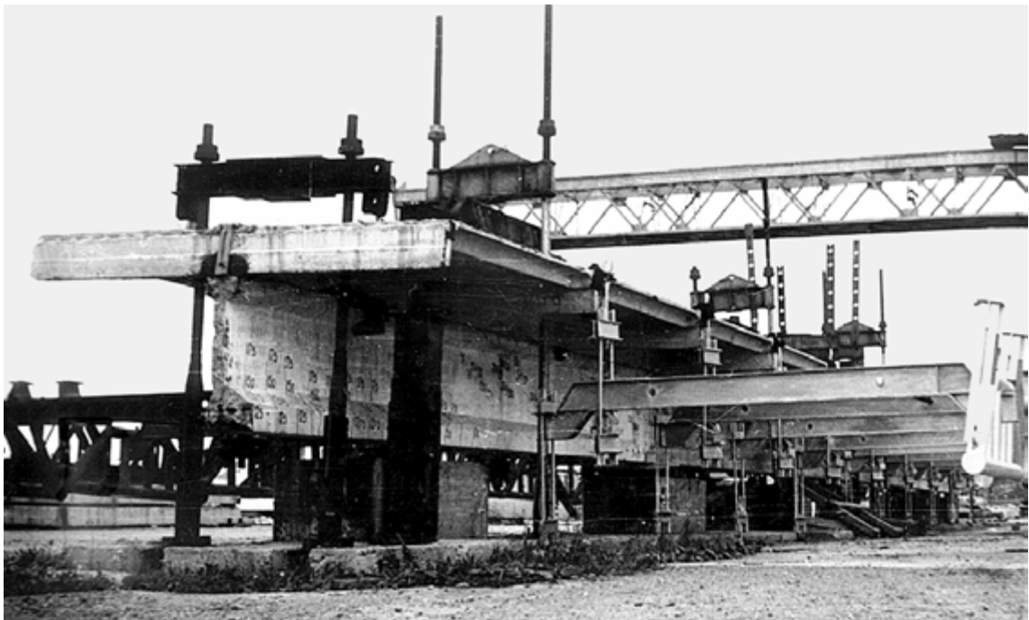
Рис. 37. Загальний вигляд випробувань фрагмента дослідної двоконсольної збірно-монолітної конструкції балки покриття прогоном 18,0 м з консольми по 9,0 м (задовжки 36,0 м) (п. 12 в табл. 1)
