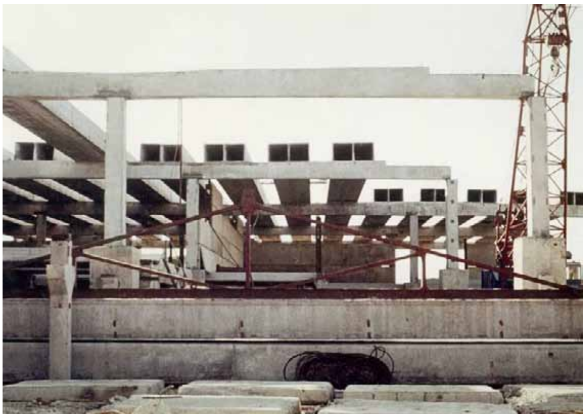
Рис. 13. Багатопрогонові нерозрізні балки покриття з прогонами 12,0 м і напруженою арматурою стиків (м. Долина, Івано-Франківської області)
