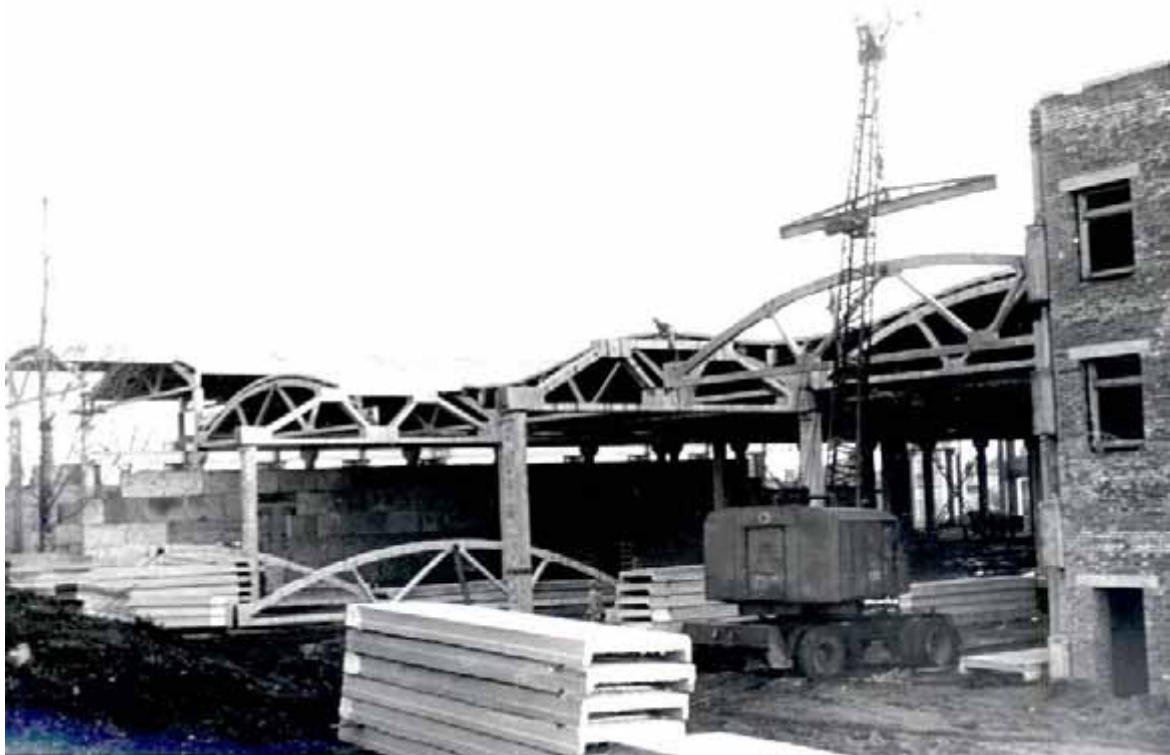
Рис. 3. Монтаж аркових залізобетонних ферм довжиною 18,0 м на будівництві інструментального заводу в м. Львові
