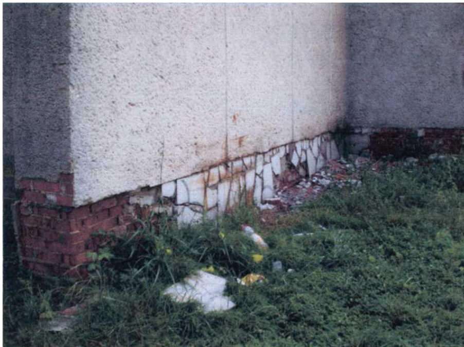
Фото 5. Руйнування цоколю внаслідок відсутності вимоцнення
