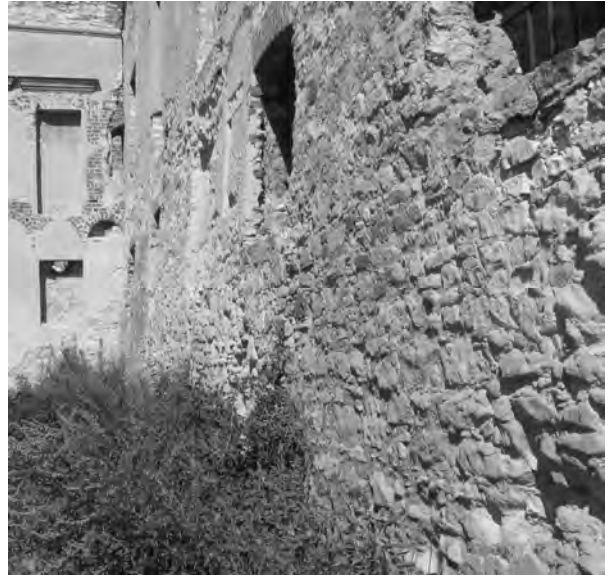
Rys. 2. Skorodowany mur na elewacji południowej Zamku. Miejsce pobrania kamienia K2 [1]
