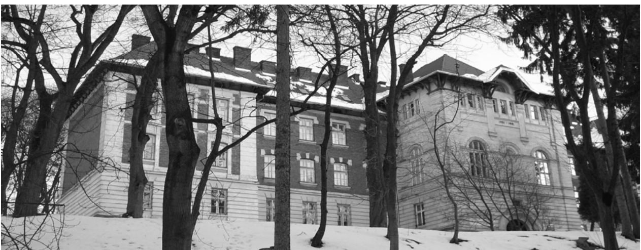
Рис. 9. Замінені історична дахівка на будівлі школи № 100 на вул. І. Франка у Львові
