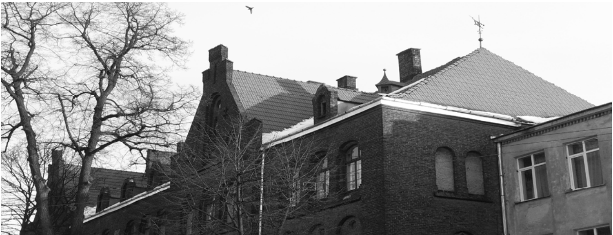
Рис. 8. Заміна історичної дахівки на нову аналогічного типу і кольористики на будівлі школи на вул. С. Бандери у Львові
