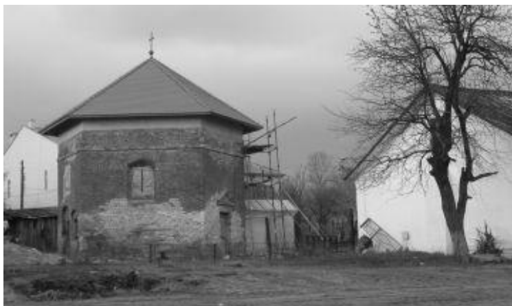
Рис. 3. Консерваційний дах з керамічної дахівки на пам'ятці архітектури XVII ст., т. зв. "аріанській каплиці" в м. Белзі
