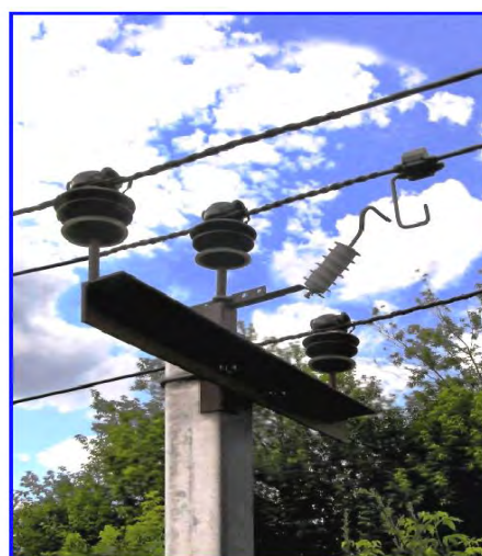
Рис. 5. Вигляд пристрою захисту від перенапруг (ПЗПН-10) на проміжній опорі [6]
