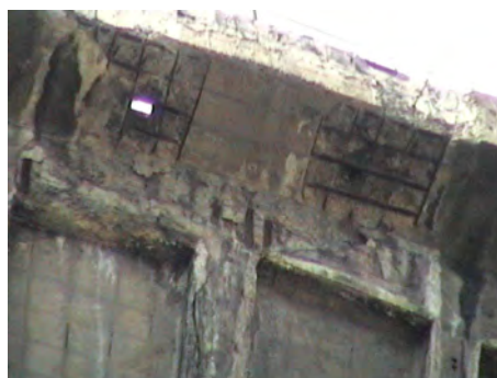
Рис. 5. Руйнування захисного шару бетону, оголення і корозія арматури та закладних деталей на верхньому ребрі жорсткості на відм. +55,1 м
