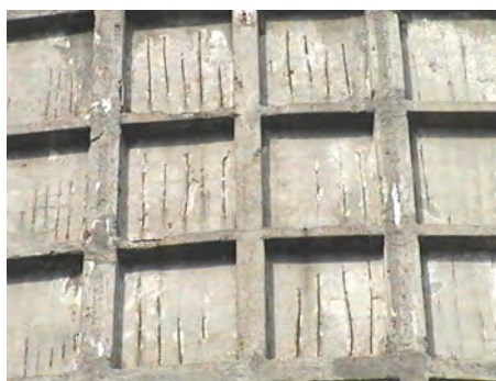
Рис. 3. Руйнування захисного шару бетону полицок ребристих плит четвертого ярусу з оголенням та корозією арматурних стержнів, якими фіксували зовнішній захисний шар (12, 14 мм) арматури сіток
