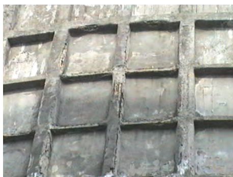
Рис. 2. Руйнування горизонтальних і вертикальних ребер з оголенням та корозією робочої арматури в плиті третього ярусу
