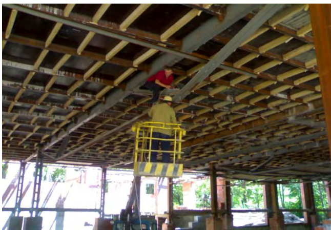
Рис. 5. Монтаж малоелементної шпренгельної ферми прольотом L=18 м. Санаторій «Женева», м. Трускавець, 2007 р
