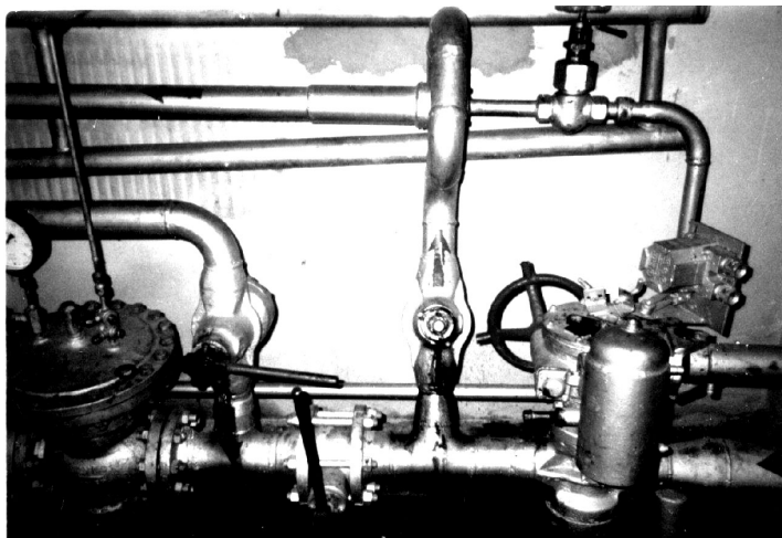
Рис. 1. Енергетичний роздільник діючої ГРС
