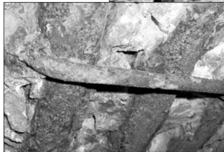
Корозійне руйнування залізобетонних конструкцій перекриття мостів і морських естакад
