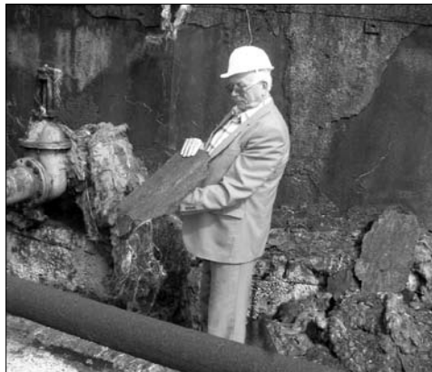
Загальний вигляд ураженого корозією резервуару гарячої води на коксохемічному заводі
